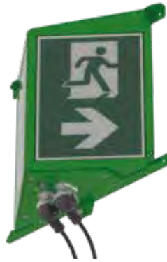
Fluchtwegsignal in der Fahrröhre vor QS montiert
